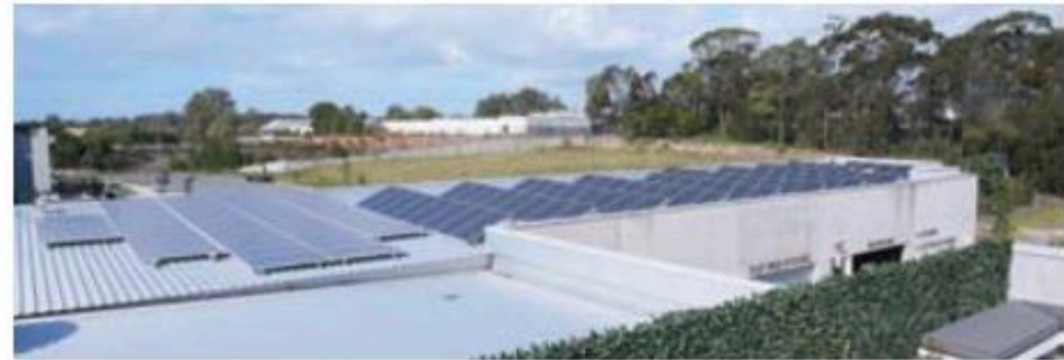
Di Henshall's solar set-up.
